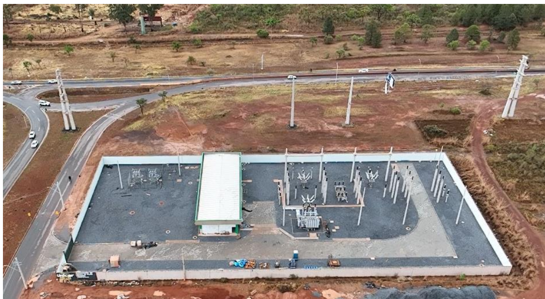
Figura 24 – Vista aérea da Subestação. Fonte: JC GONTIJO ENGENHARIA (2025)
