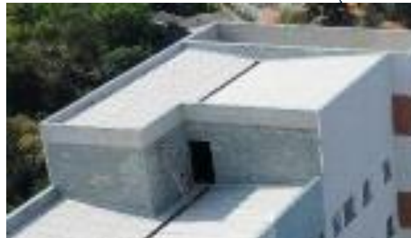
Figura 49: Detalhe de ausência/divergências de revestimento externo na cobertura da edificação.
