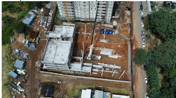
Figura 45: Execução de edifício garagem, com parte da estrutura no último pavimento (à esquerda da foto) e outra parte ainda não iniciada (à direita da foto).
