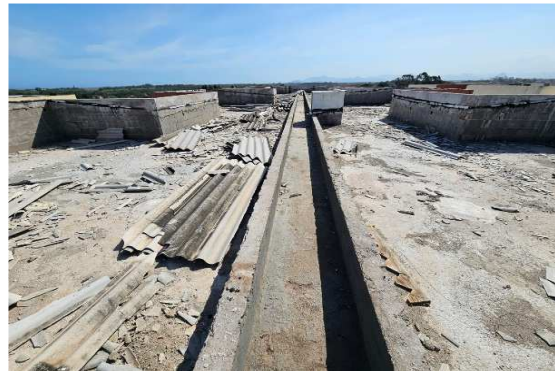
Cobertura – furto telhas e estrutura
