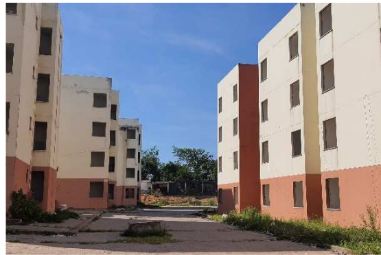
Vista geral – furto esquadrias Vista geral – furto esquadrias
